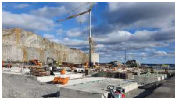
Les futures citernes de stockage temporaire de CO2 du Northern Lights - Photo Boris Haller RadioFrance
