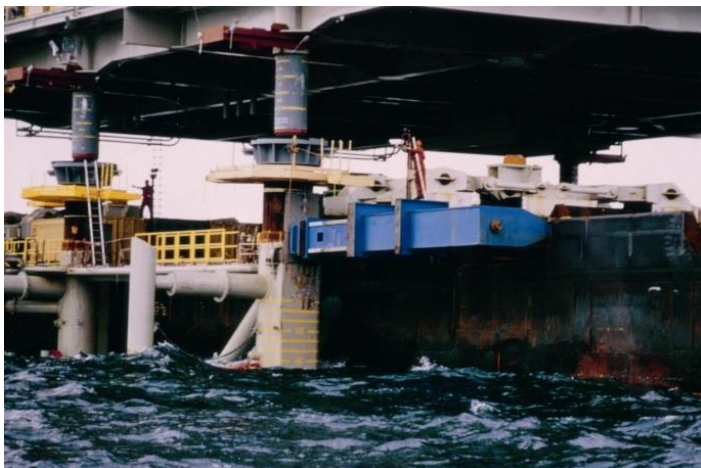
Pont EKPE immobilisé. Supports effondrés. Système anti-cavement (en bleu) encore actif.
